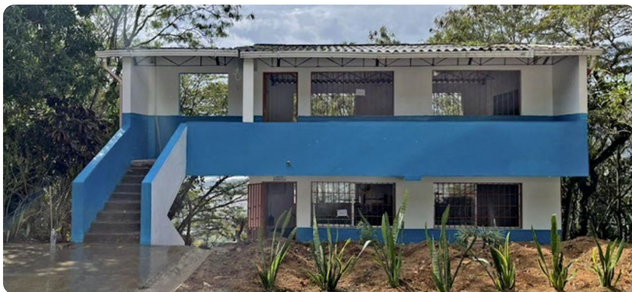
Arreglo de la fachada de la escuela La Meseta, en Girardota, Antioquia, lograda con donaciones en especie.
